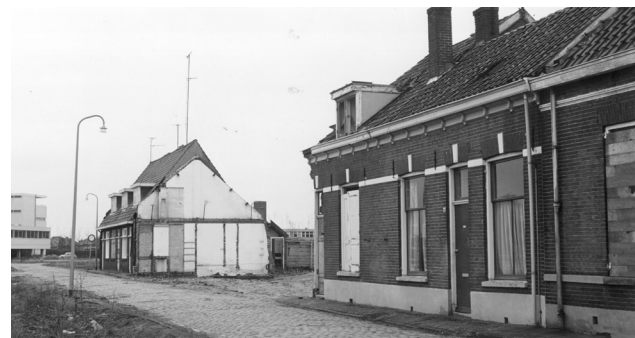
Het slopen van de bestaande kleinschalige woonhuizen om plaats te maken voor de campusachtige setting met vrijstaande gebouwen 1971
